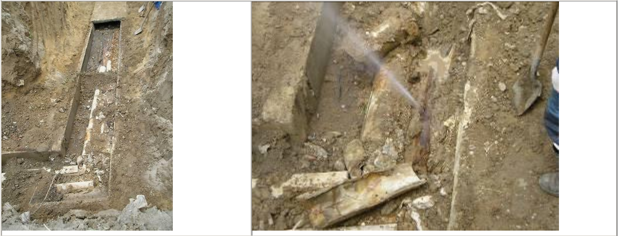
Рис 7. Отсутствие свободного выхода струи. Течь прибором не обнаружена.
