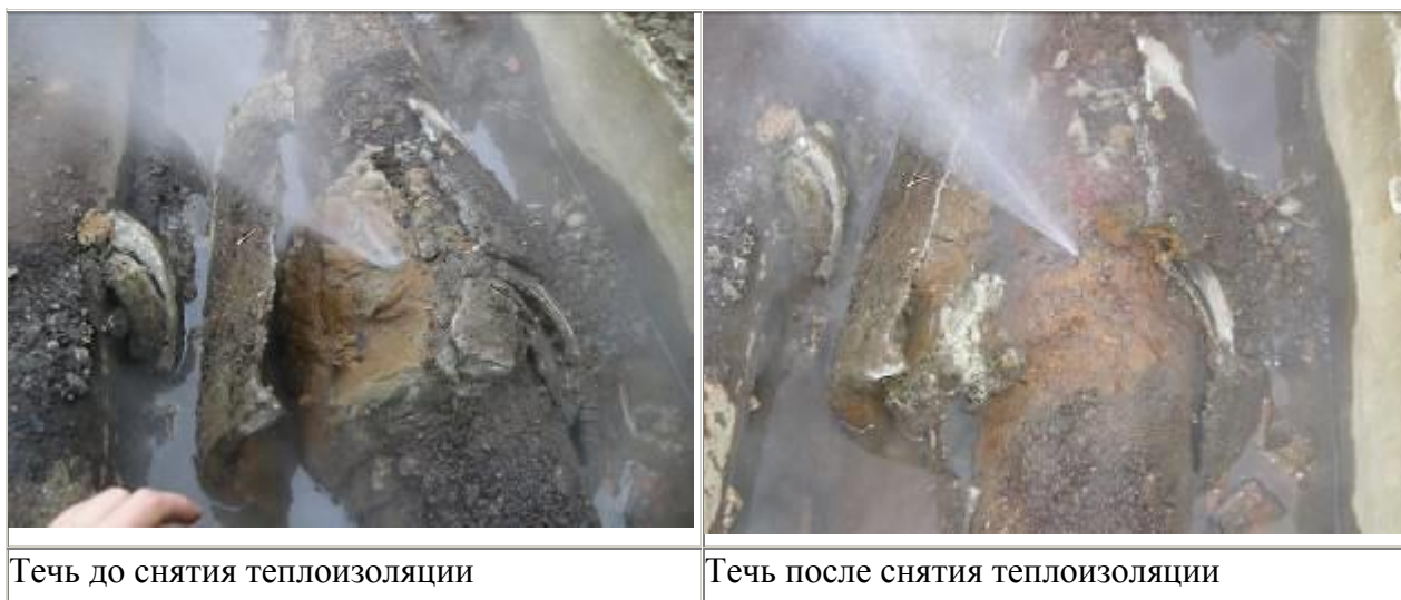
Рис 6. Снижение энергии сигнала от течи за счет «стесненного» выхода через теплоизоляцию.
